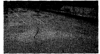
16(1) 呉高専テニスコート地割れと噴泥
